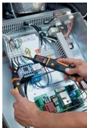
Измерение напряжения на компрессоре.
